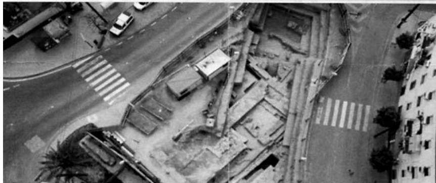
A cielo abierto. Vista aérea de las excavaciones realizadas en la plaza del Doctor Cariñanos, en el Monumento.
